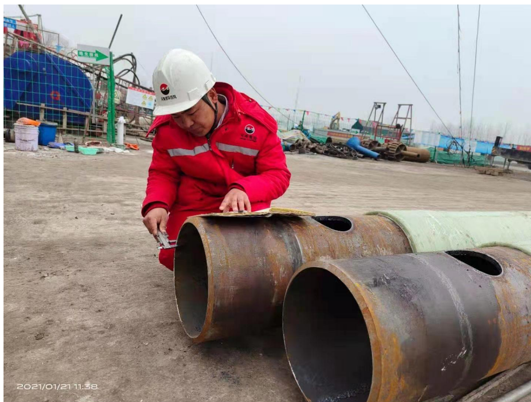
赵文杰在安徽涡北煤矿集中降温系统保温钻孔项目丈量保温套管壁厚
